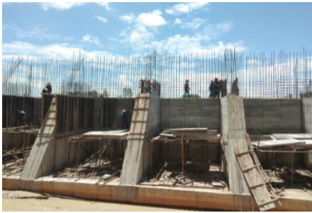
ประตูระบายน้ำ
