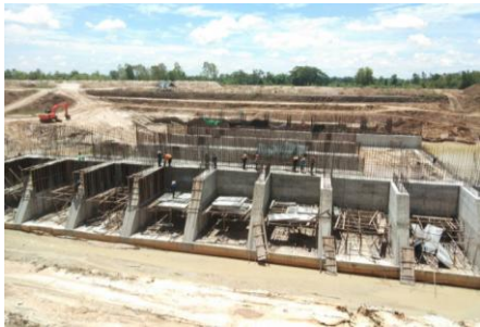
ประตูระบายน้ำ
