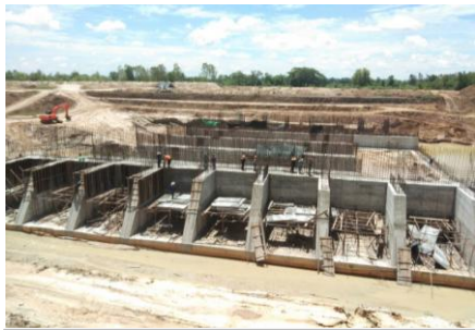
ประตูระบายน้ำ
