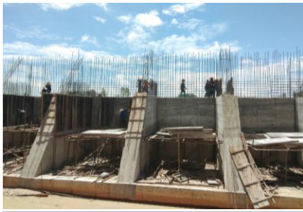
ประตูระบายน้ำ
