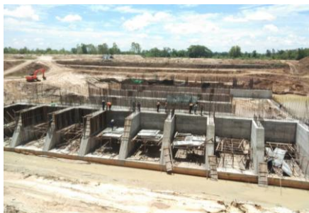
ประตูระบายน้ำ
