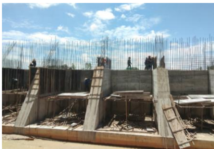
ประตูระบายน้ำ
