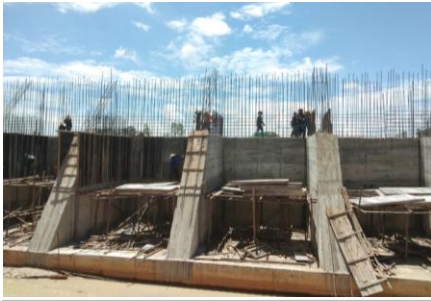
ประตูประบายน้ำ
