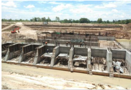
ประตูประบายน้ำ
