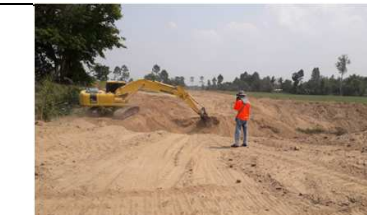
งานขุดบ่อก่อสร้างอาคาร กม.4+852.15 (1R-LMC)
