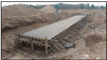
ท่อลอดถนนพร้อมรางฯ กม.0+070 (1R-RMC)
