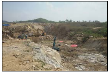
งานปรับปรุงฐานรากบริเวณร่องแกนเขื่อนหลัก
