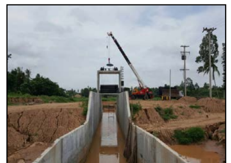
กิจกรรมก่อสร้าง ประตู.คลองชักน้ำแม่น้ำน่าน-คลองอ้ายคก
